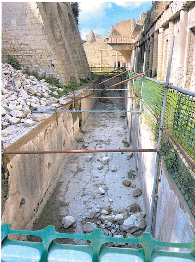
Figura 10 - presenza di materiale crollato all'interno della vasca
