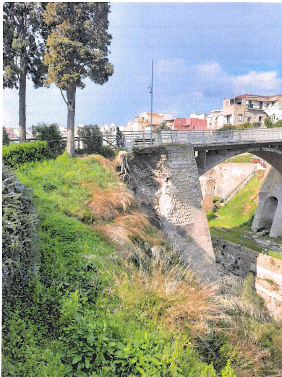
Particolare della parte crollata; vista dal Parco Maiuri
